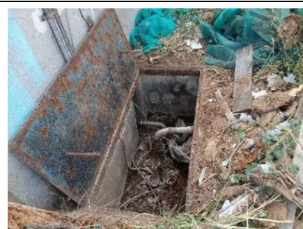
Arqueta con conducciones quizás asociada al antiguo depósito enterrado.
