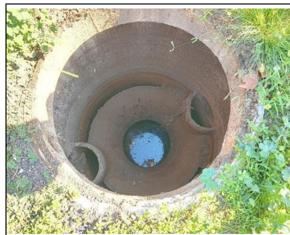
Interior de las arquetas (3)
