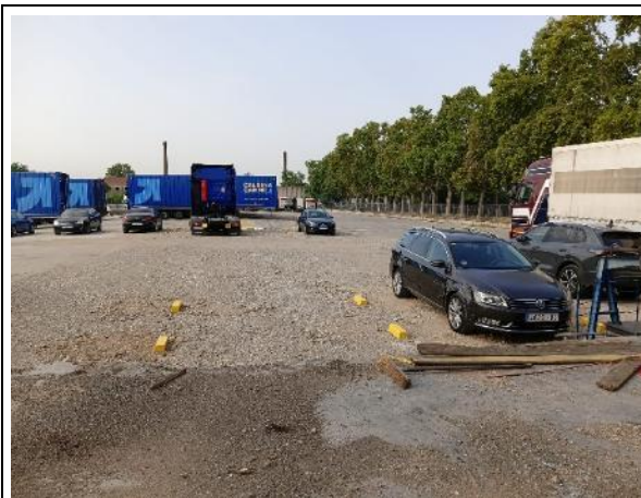
Extremo sur. Nave derribada. (parcelas #3 i #4)
