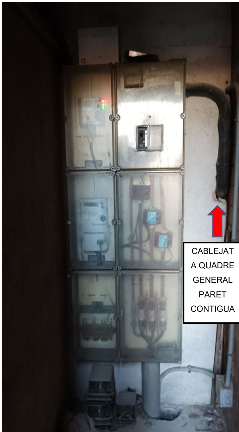
Imatge 7: Escomesa elèctrica TMF10 existent
