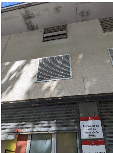
Imatge 2. Orificis a façana c/ Agricultura per a extracció i absorció d'aire
