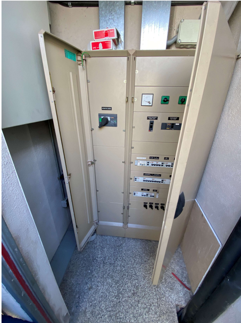
Imatge 12: Quadre on es connectarà la instal·lació de la coberta de l'edifici institucional
