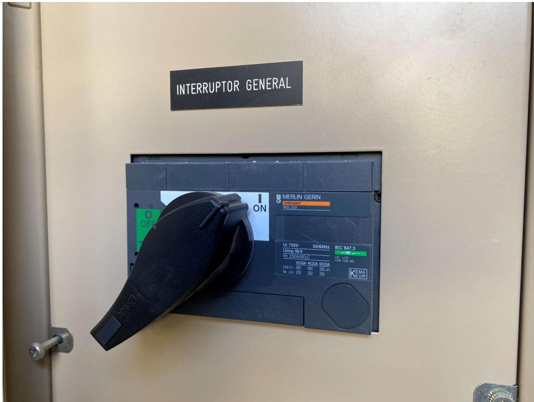
Imatge 13: Interruptor diferencial on es connectarà la instal·lació de la coberta de l'edifici institucional
