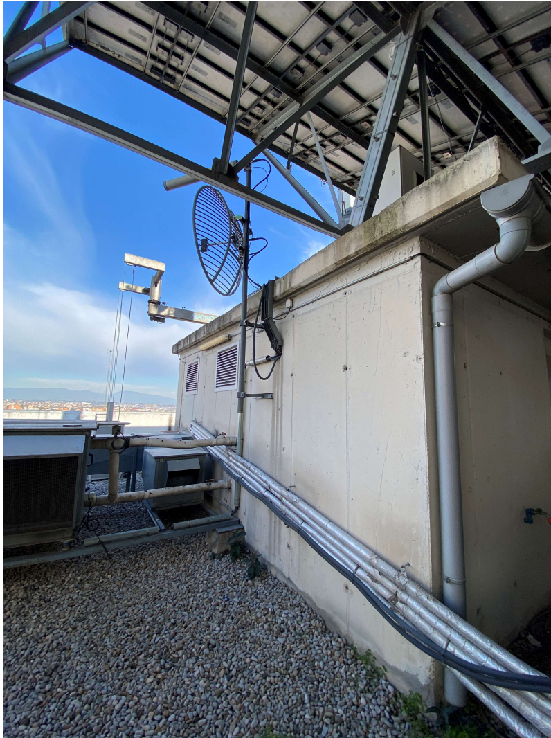
Imatge 5: Paret exterior de la coberta de l'edifici administratiu on s'instal·laran el nou inversor i els quadres de proteccions DC i AC
