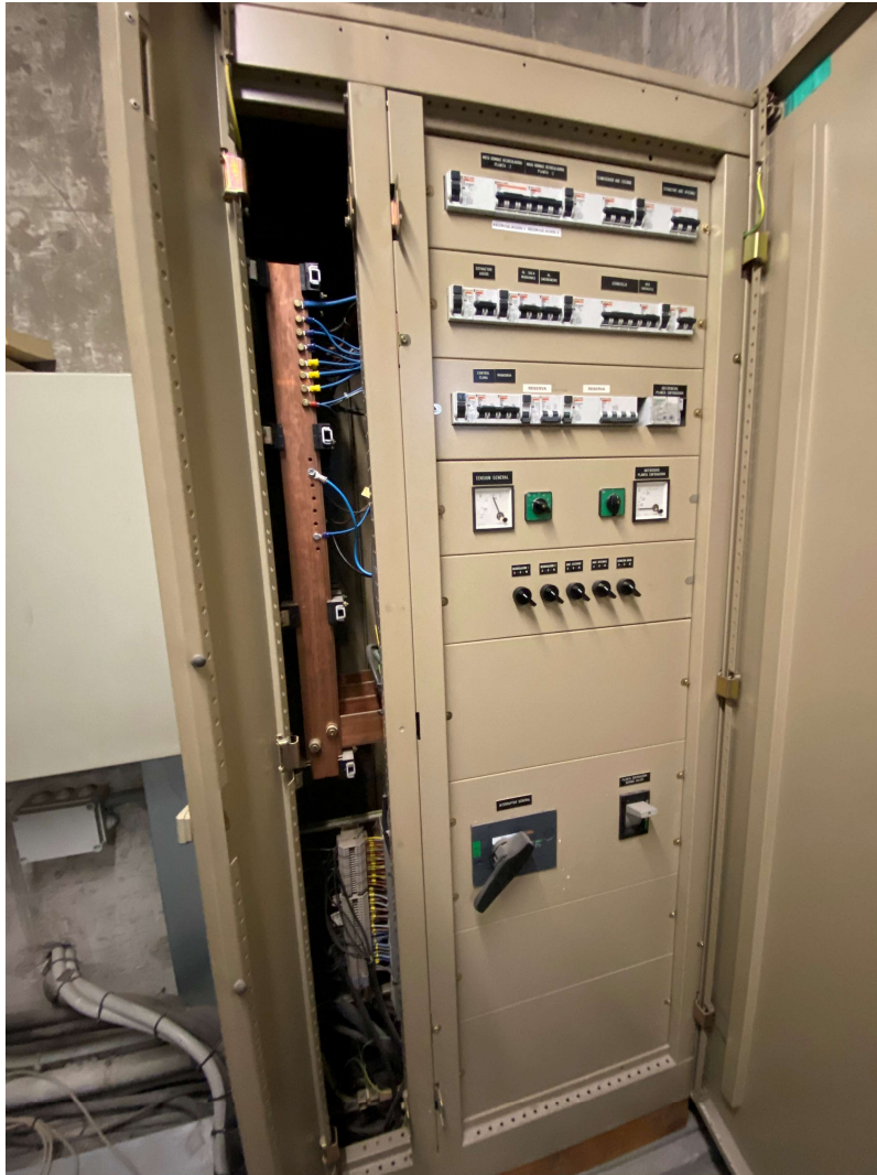
Imatge 6: Quadre on es connectaran els inversors de l'autoconsum col·lectiu, situat a la coberta de l'edifici administratiu
