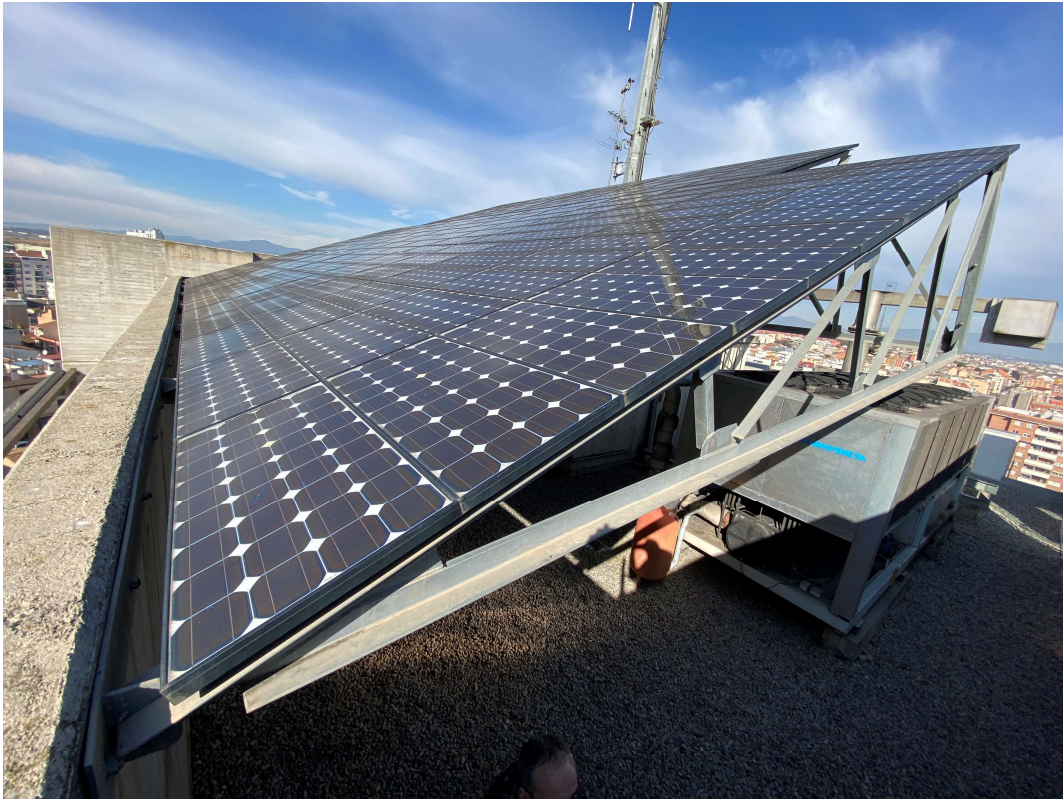
Imatge 1: Instal·lació fotovoltaica existent a la coberta de l'edifici administratiu
