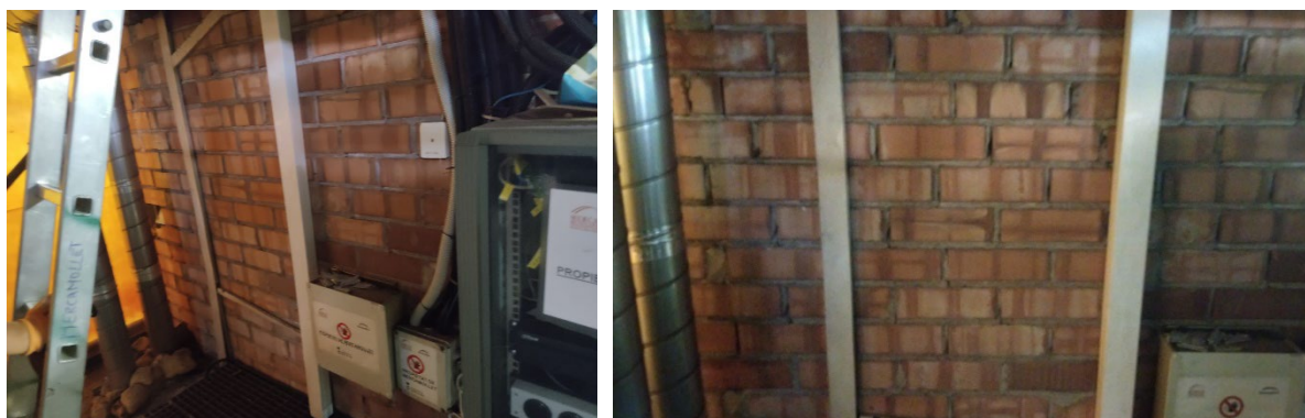
Il·lustració 29 Espai destinat a l'inversor i a les proteccions
