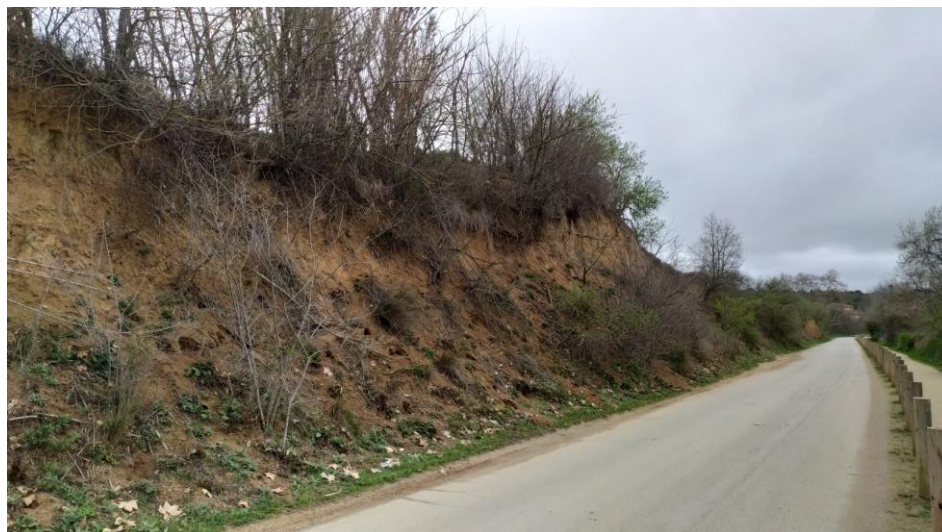
Figura 22. Talús considerat amb indicis i perillositat baixa per esllavissades, al camí dels Gallecs
