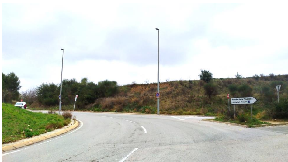
Figura 23. Talús amb esllavissada M2, on s'ha considerat perillositat baixa per esllavissades, a la Ronda dels Pinetons.
